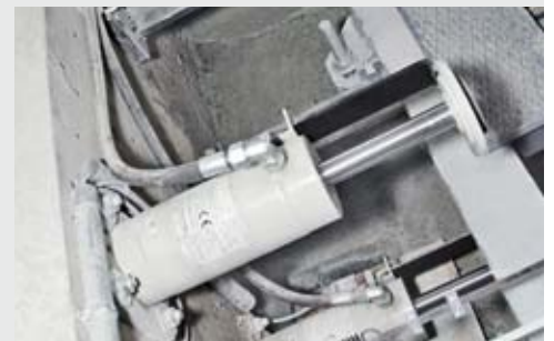
Die Sicherheitspuffer in der Schachtgrube
